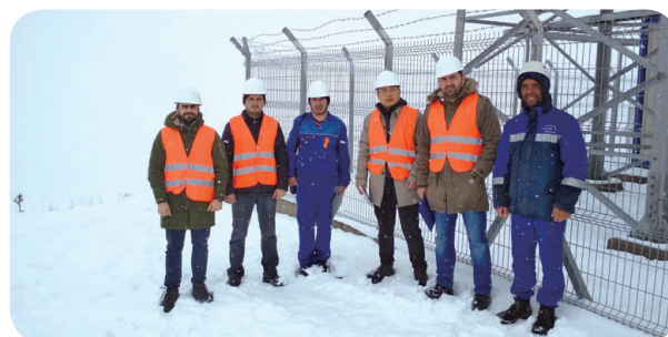
Наши партнеры вместе с обслуживающим персоналом компании Huawei проверяют надежность монтажа объекта (фото Тогула Муртузаева).
