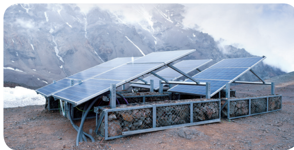
Гибридная система электропитания Huawei, помогающая расширять сети в удаленных регионах
